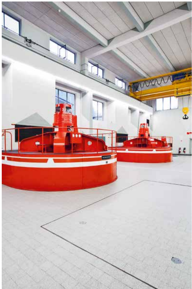
Der Maschinensaal des Kraftwerks Wernisberg.
